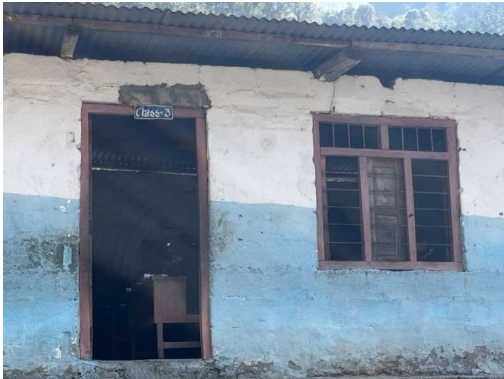
Die Bestandsgebäude der Schule sind in einem sehr einfachen und fast baufälligen Zustand
